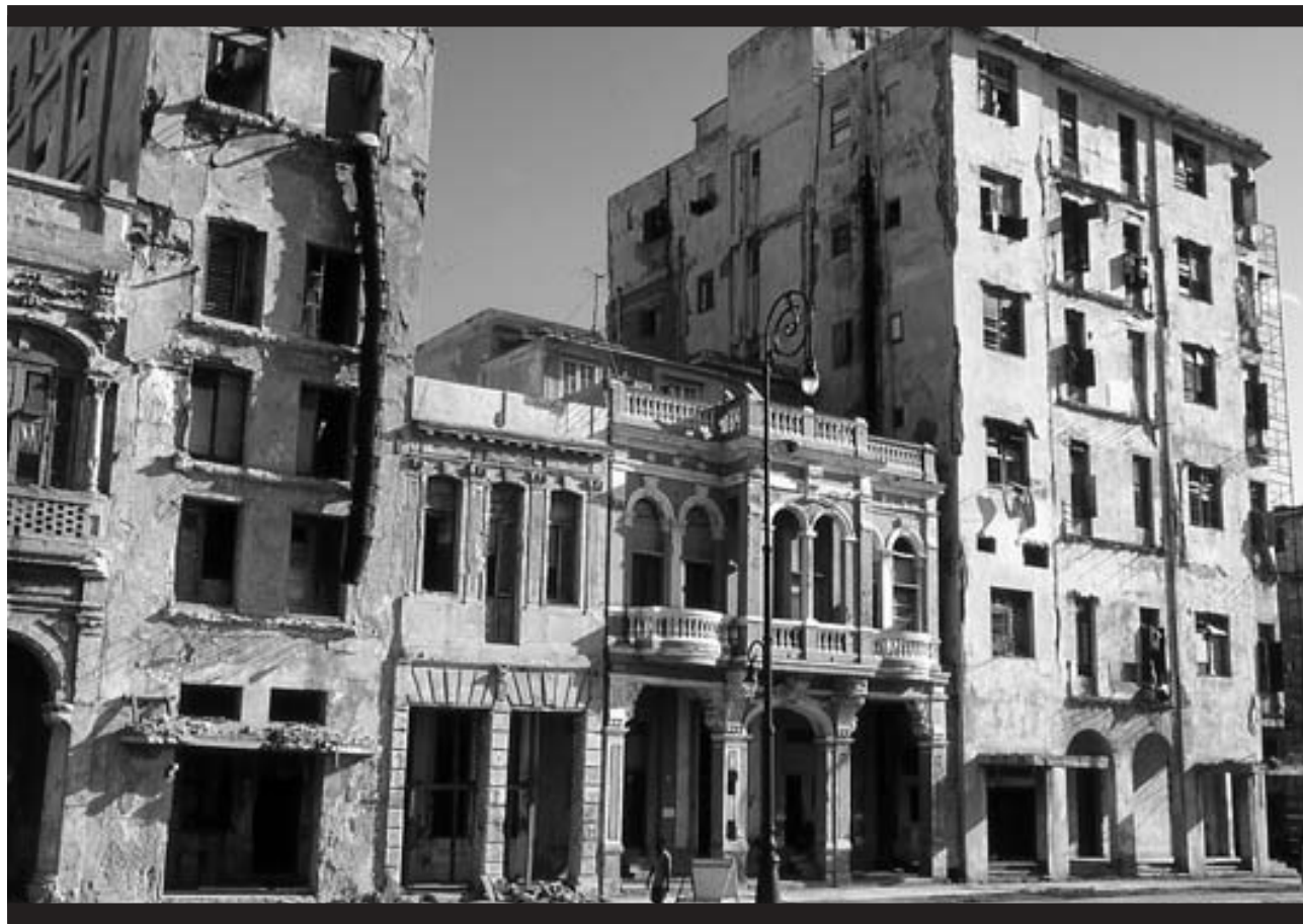
La Havane. Immeubles menaçant de s'écrouler.
